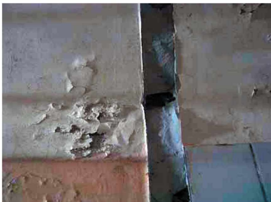
Рис. 1. Разрушенная гидроизоляция и элементы нарушенной структуры материалов
