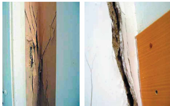
Рис. 2. Биоповреждения, образовавшиеся после 2 лет некачественного ремонта
