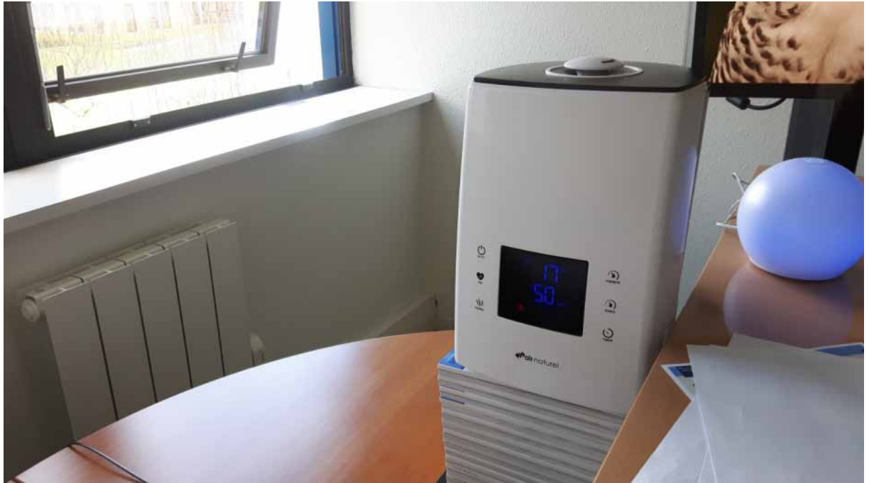
Figure 10 Vue des éléments de maîtrise de l'ambiance thermique et hygrométrique
