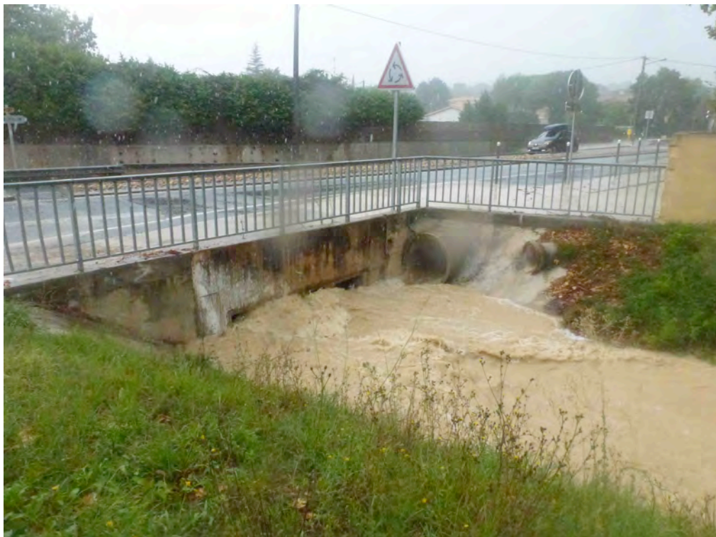
Photo 4. Passage de l'eau sous la D21 à Castelnau près de Navitau, 23 août 2015 à 18h15, à la fin de l'épisode pluvieux.
