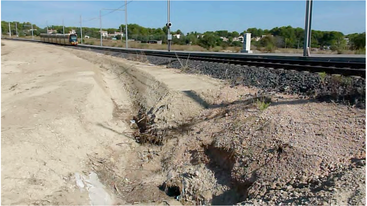
Photo 3. L'évacuation des eaux par un conduit de 40 cm de diamètre (à moitié obstrué) passant sous la ligne de tramway à l'Est de mas de Caylus.
