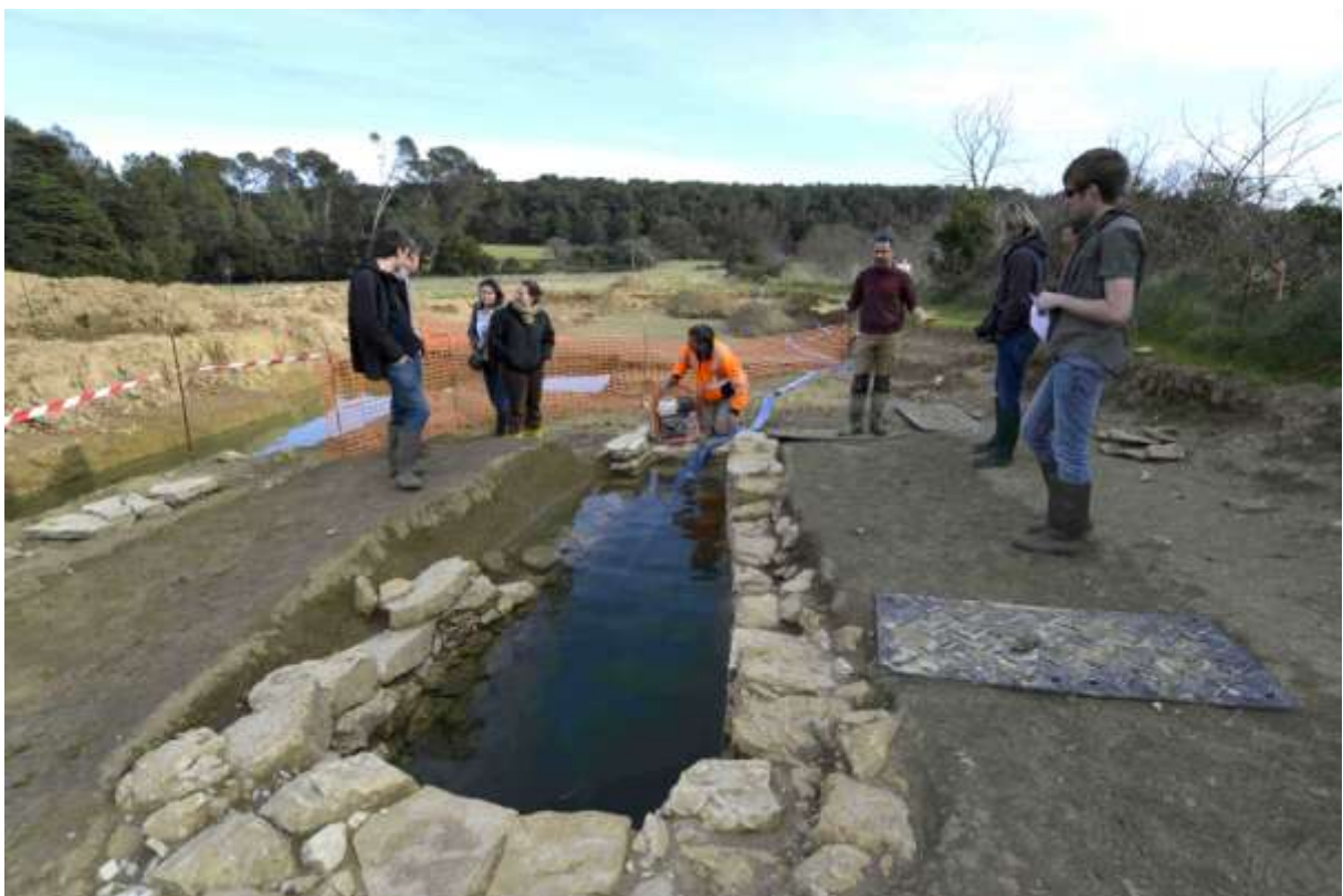
Préparation de la vidange du réservoir rempli par la source.
