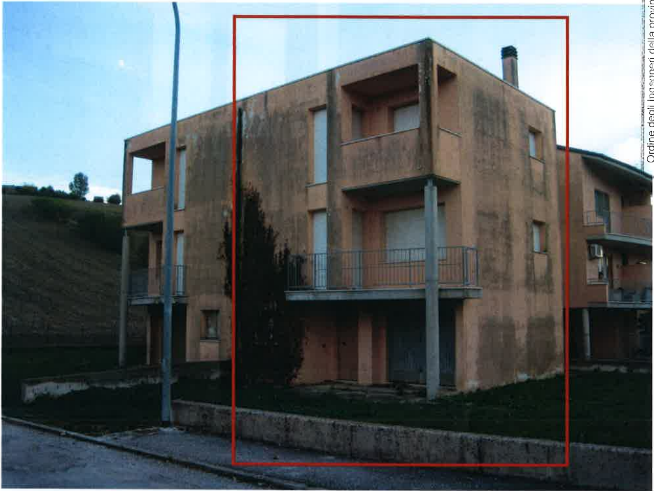
Vista dei prospetti Nord – Est e Nord- Ovest sui quale sono collocate le unità immobiliari oggetto di stima dell'ingresso a piano terra all'appartamento e al garage.
