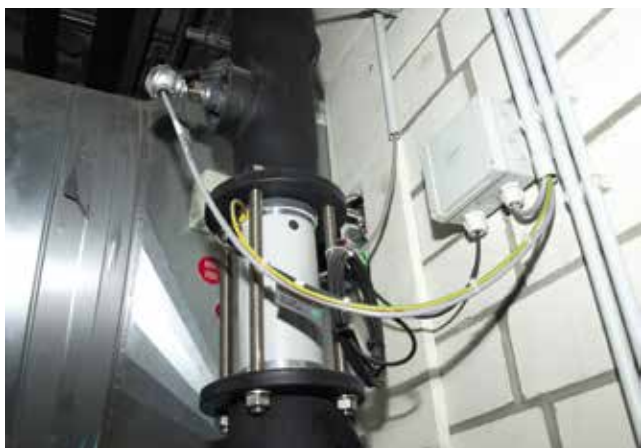
04 Расходомеры с датчиками температуры регистрируют количество холодной воды и связаны с системой визуализации по протоколу Modbus
