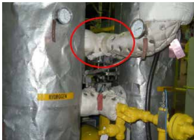
4 На фото, сделанном камерой для оптической визуализации газа, видна утечка в осушителе водорода. С помощью камеры Flir GF343 операторы могут произвести осмотр осушителя водорода, не останавливая генератор
