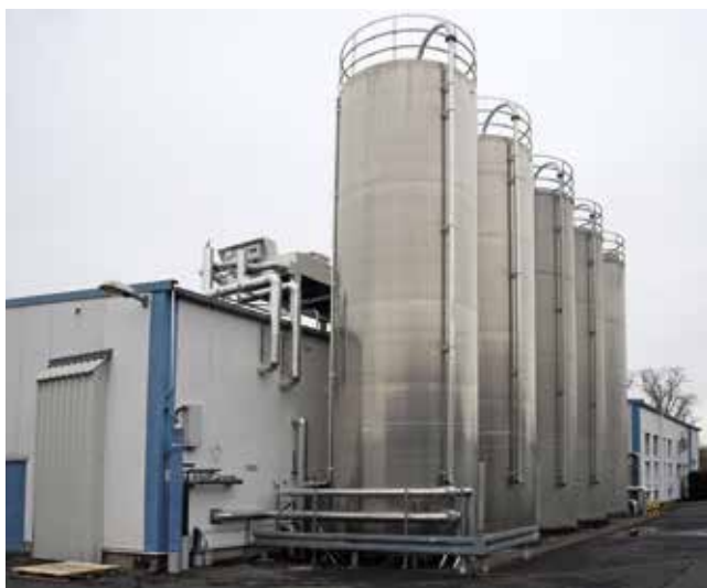
02 Новый свободный охладитель снабжает цистерну под силосом холодной водой
