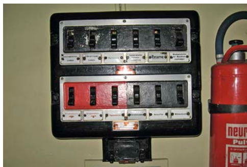
Die Schalteranordnung im Führerstand; rot markiert sind die Strecken- und Signallaternenschalter
