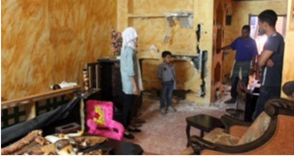
عائلة تُعاين الدمار الذي خلفه الجنود في بيتها بمُخيم بلاطة لللاجئين، 17.6.2014. تصوير: أحمد الباز، أكتيفيستيلز
