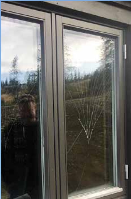
Trykkbruddet har oppstått ganske raskt etter at denne hytta ble oppført – andre ganger kan det ta lenger tid. (Foto: Tipser)
