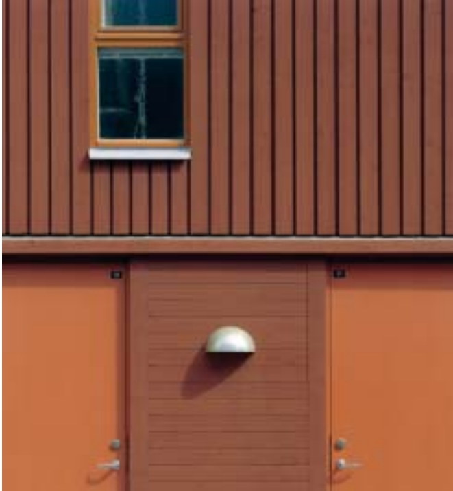
Panelen är behandlad med slamfärg.
