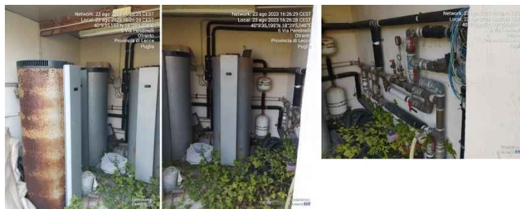
Figura 12 - LOCALE DISTRIBUZIONE ACQUA CALDA SANITARIA
