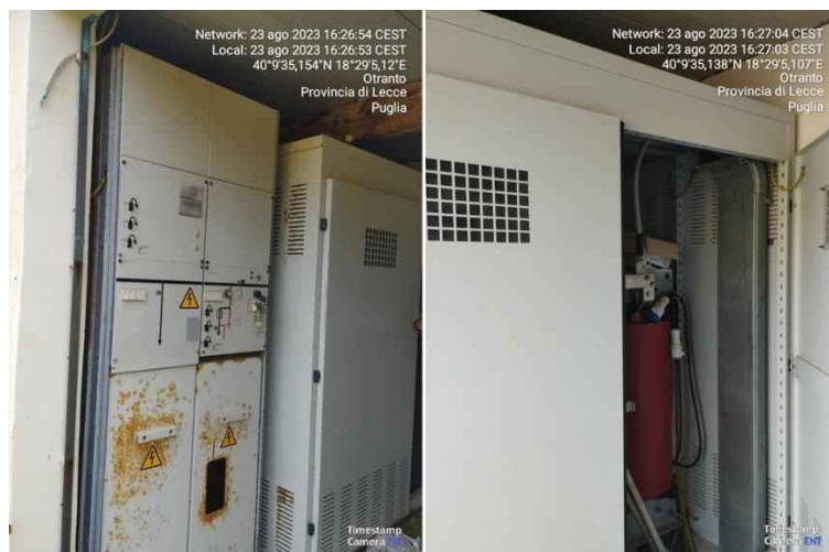
Figura 11 – LOCALE QUADRI ELETTRICI
