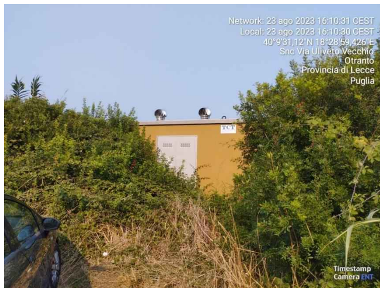
Figura 8 - CABINA TARSFORMAZIONE MT-BT
