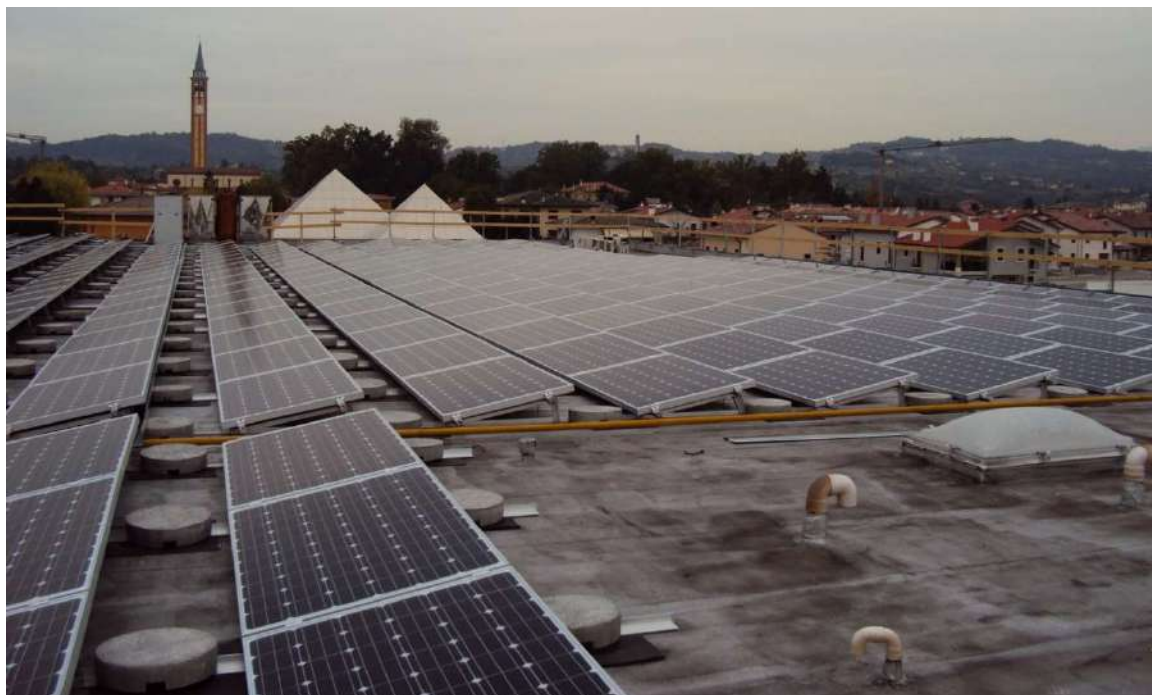
Immagine dell'impianto fotovoltaico in copertura
