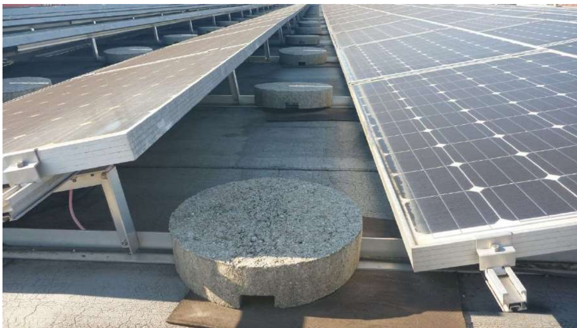
Immagine struttura di sostegno dei moduli e delle zavorre utilizzate
