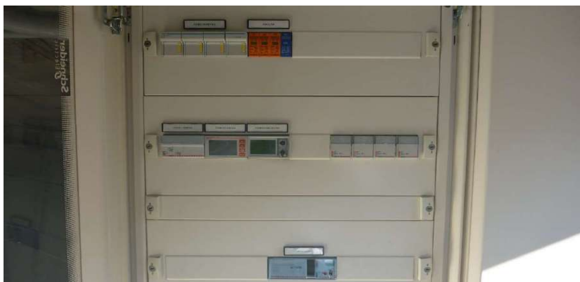
Quadro generale di interfaccia
