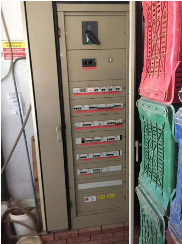
24 N. 2 quadri elettrici generali e quadri derivati a norma (da considerare facenti parte dell'immobile)
