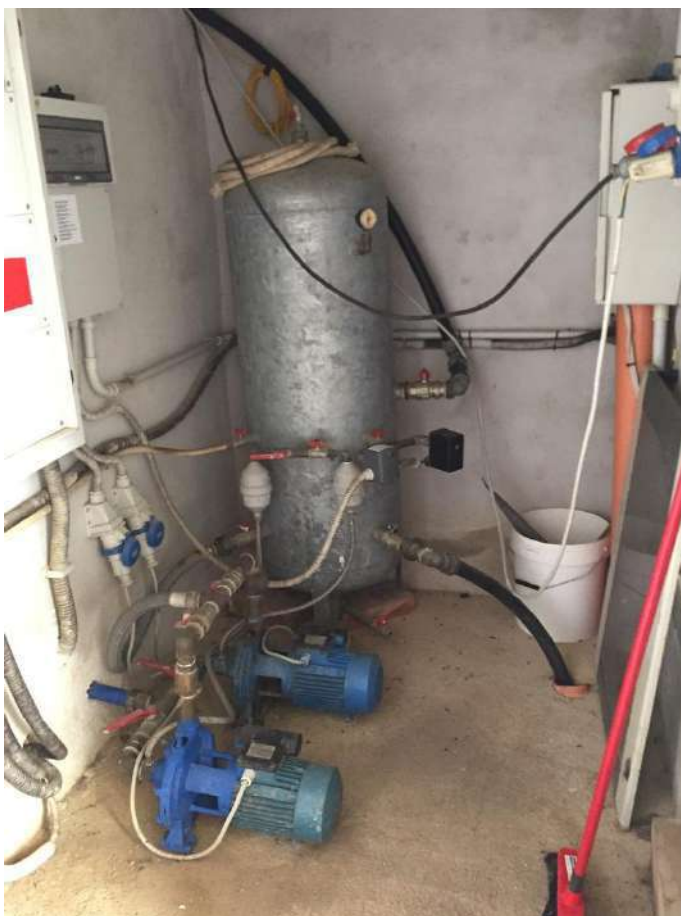
19 N. 1 impianto autoclave (da considerare compreso nell'immobile)
