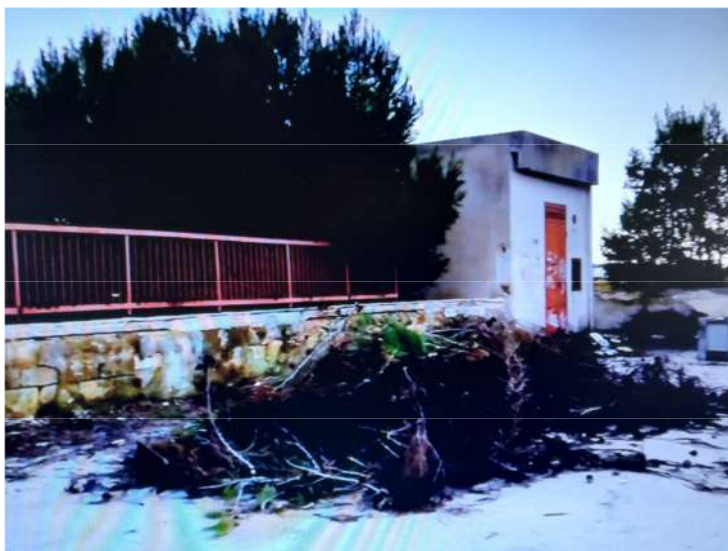
FOTO 2 – CORPO D CABINA ELETTRICA
