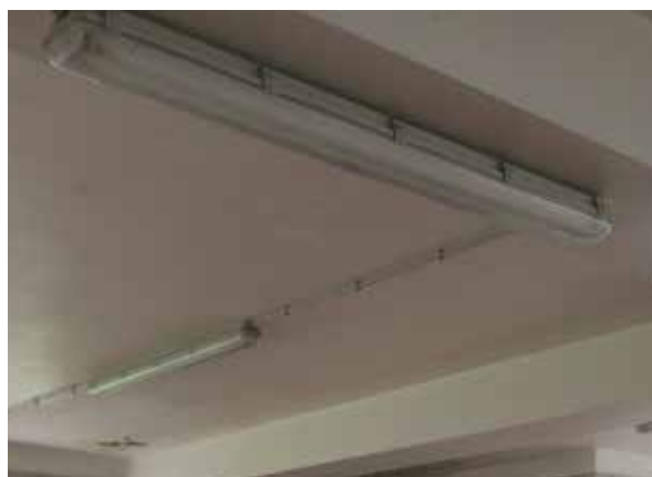
111. N. 4 neon doppi (Edificio A - 1° Piano)
