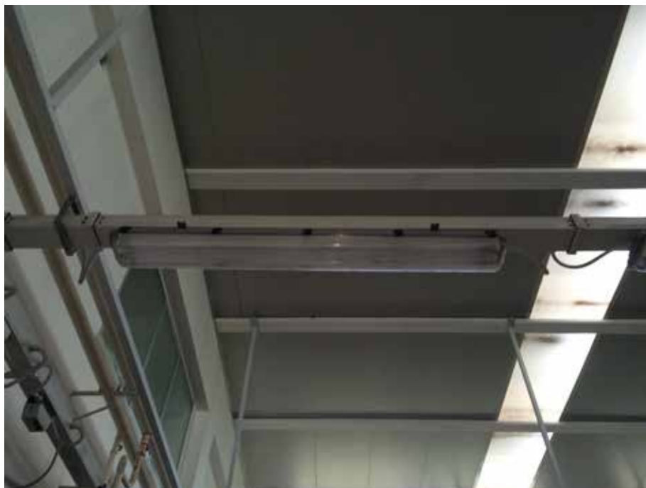
27 e 45. N. 33 plafoniere a neon di circa 1,20 m ciascuna (Sala 1 - Edificio A).
