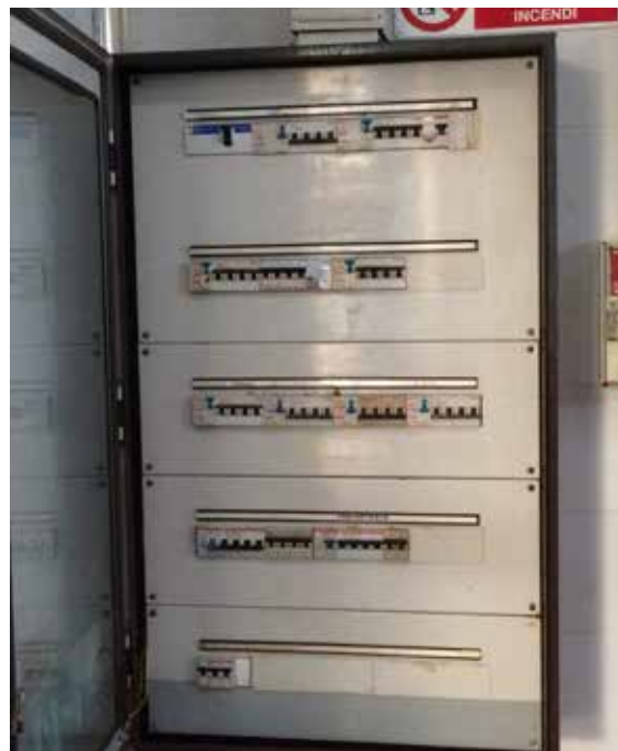
31. N. 2 quadri elettrici per impianti industriali (Sala 1 - Edificio A).
