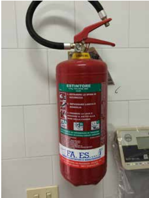
189. Estintore da 6 kg (Edificio A - P. Terra zona laboratorio)
