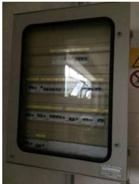
95. Quadro elettrico per impianto industriale (Edificio A - 1° Piano)
