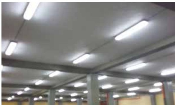
331. N. 96 plafoniere a due neon (Edificio B - Piano cantinato)
