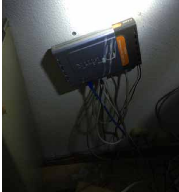
139. Router D-LINK (Edificio A - 1° Piano zona direzione)
