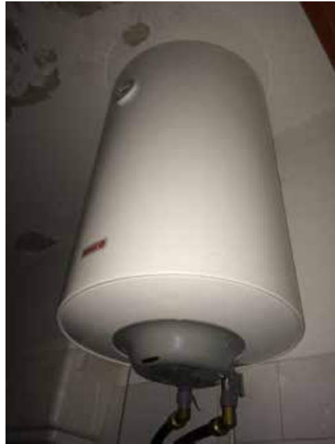
184. Scaldabagno SIMAT (Edificio A - 1° Piano zona direzione)
