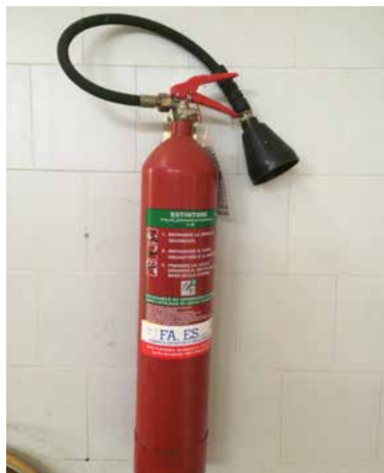
35. N. 2 estintori da 5 kg e N. 1 estintori da 6 kg (Sala 1 - Edificio A).
