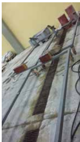
347. N. 3 carrelli barca statici (Edificio B - Piano cantinato)
