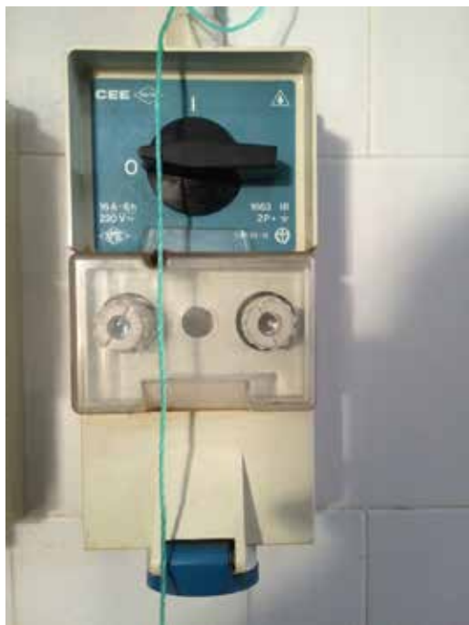
76. N. 4 interruttori - prese da 220 V (Zona confezionamento - Edificio A).
