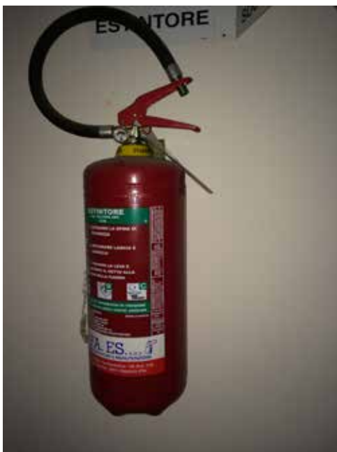
167. Estintore da 6 kg (Edificio A - 1° Piano zona direzione)
