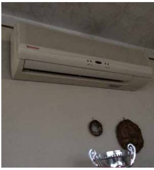
121. Pompa di calore NGiorgio (Edificio A - 1° Piano zona direzione)
