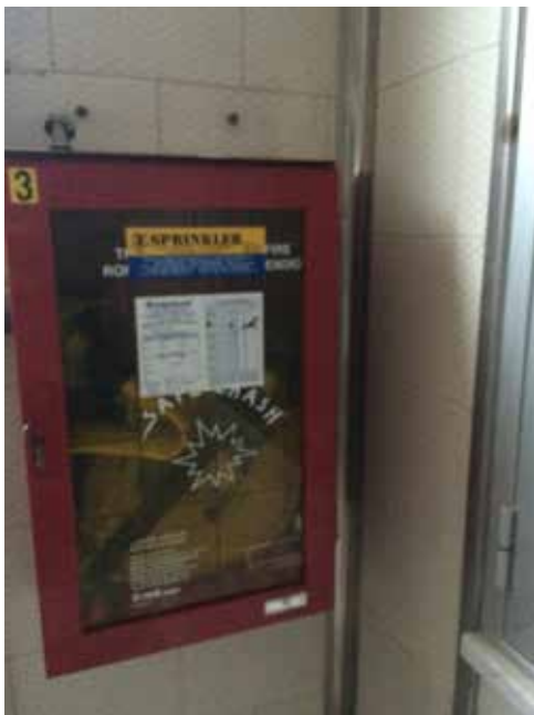
94. Idrante Sprinkler (Edificio A - 1° Piano)
