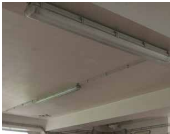
89. N. 15 lampade a neon doppio (Edificio A - 1° Piano)
