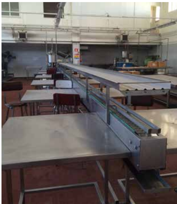
20. N. 3 rulli a nastro per la lavorazione del pesce (Edificio A).
