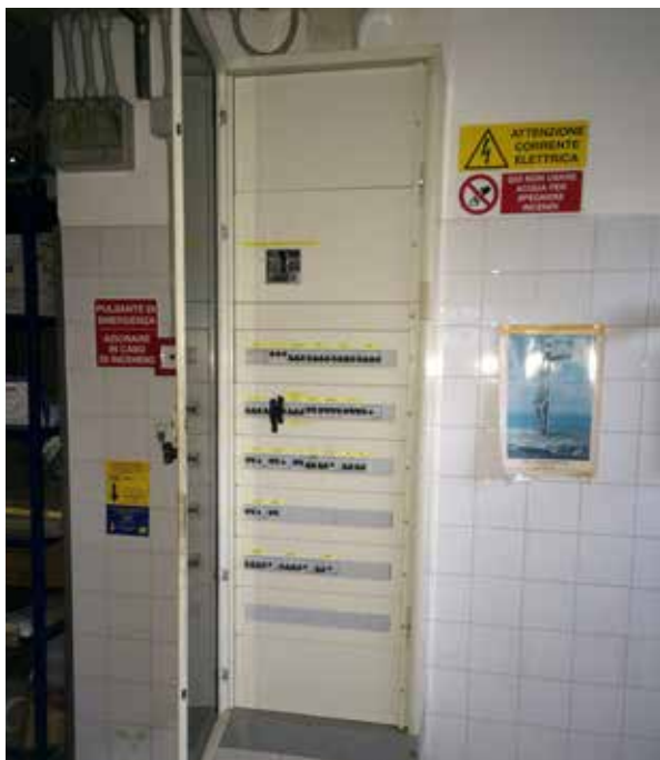
69. Quadro elettrico per impianto industriale (Zona confezionamento - Edificio A).
