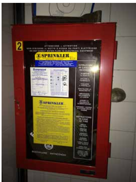
78. Manichetta idrante antincendio (Zona confezionamento - Edificio A).
