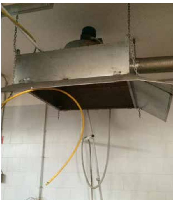
32. Cappa aspirante in acciaio (Sala 1 - Edificio A).
