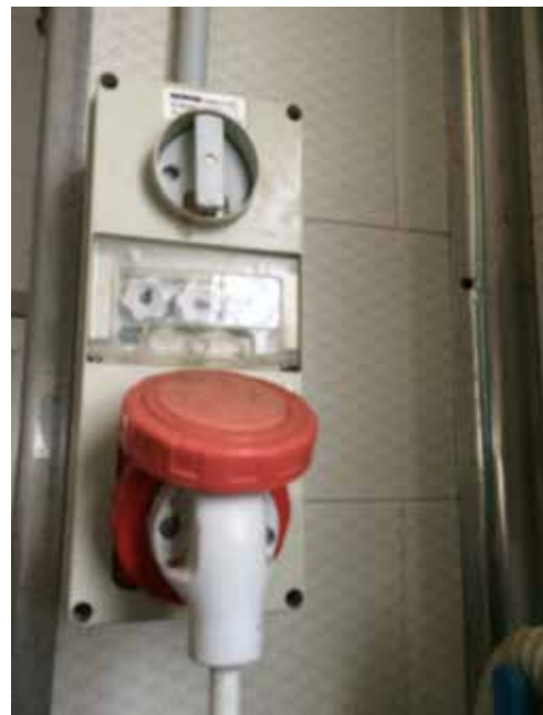
87. N. 2 quadri elettrici (Edificio A - 1° Piano)
