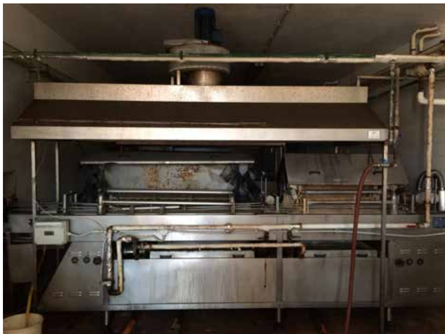
37. Prolungamenti rulli trasportatori di cui al n. 20 dell'inventario (Sala lavaggio - Edificio A).
