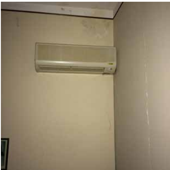
159. Pompa di calore GUFIRE (Edificio A - 1° Piano zona direzione)
