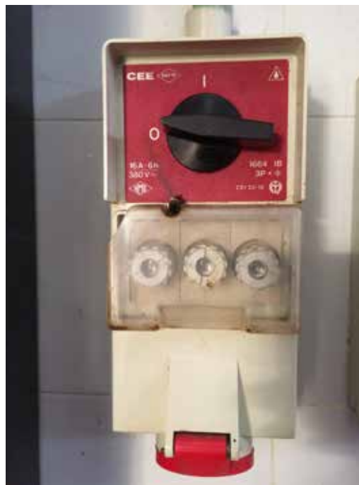
77. N. 1 interruttori - prese da 380 V (Zona confezionamento - Edificio A).
