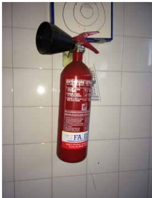
44. Estintore da 2 kg (Sala lavaggio - Edificio A).
