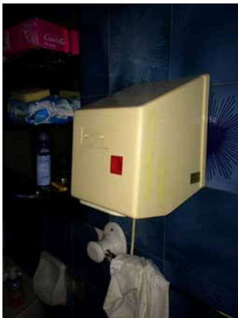
142. Asciugamani elettrico (Edificio A - 1° Piano zona direzione)
