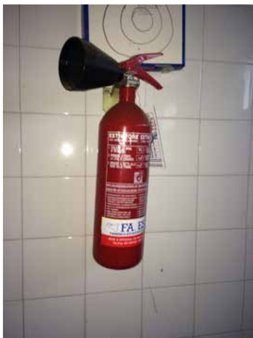
67. N. 2 estintori di cui uno da 2 kg e uno da 6 kg (Zona confezionamento - Edificio A).
