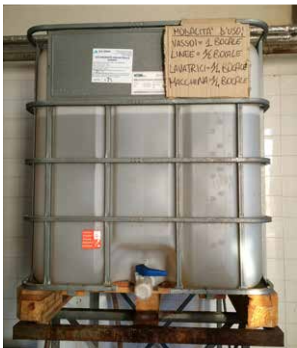
38. Recipiente in plastica contenente 750 l di detergente ALCA CHIMICA (Sala lavaggio - Edificio A).
