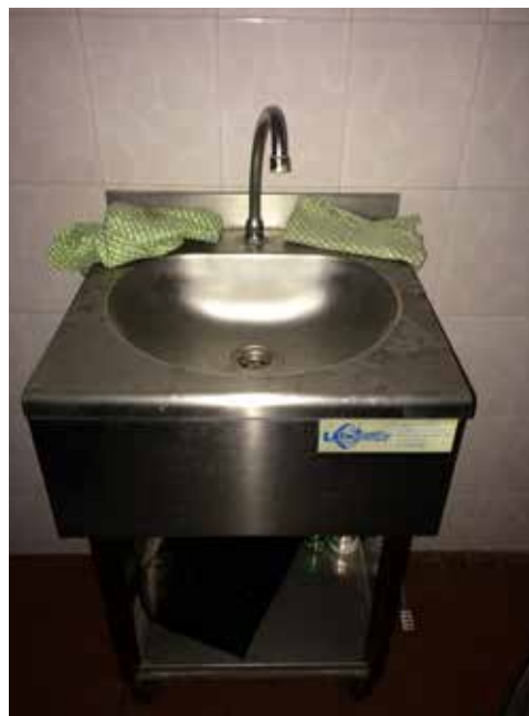
97. Lavandino in acciaio 0,5 m x 0,5 m con pedali (Edificio A - 1° Piano)
