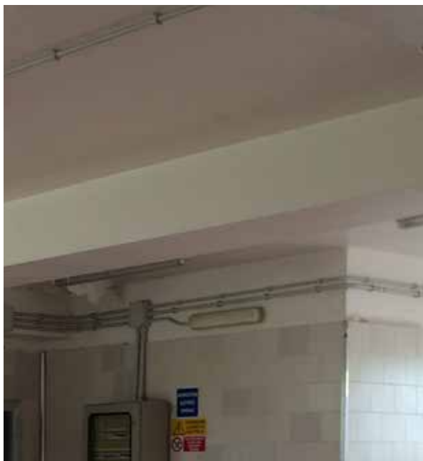
112. Neon di emergenza (Edificio A - 1° Piano)
