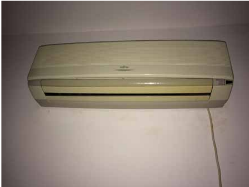
180. Pompa di calore FUJITSU (Edificio A - 1° Piano zona direzione)
