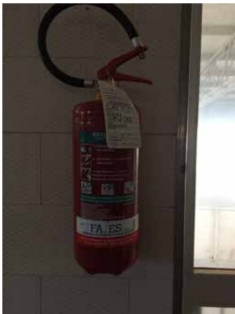
88. N. 3 estintori da 6 kg (Edificio A - 1° Piano)
