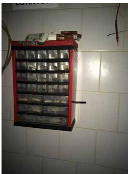
72. Contenitore per fusibili, con fusibili di varie dimensioni (Zona confezionamento - Edificio A).
