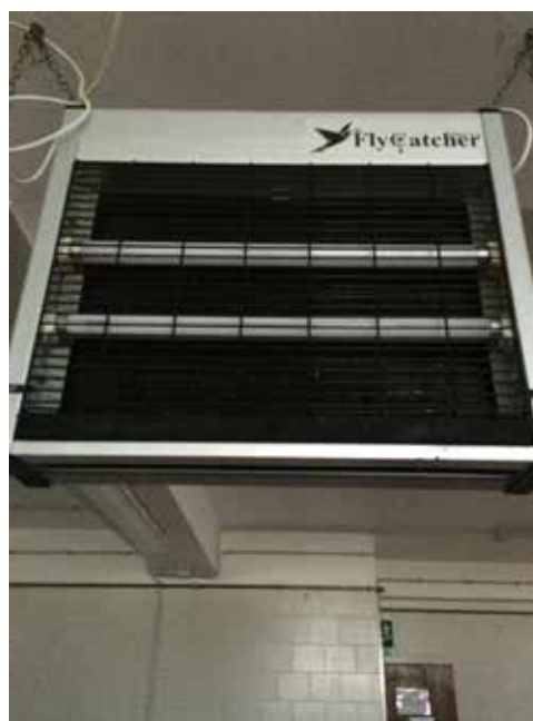
91. N. 2 Fly Catcher - caccia insetti (Edificio A - 1° Piano)
