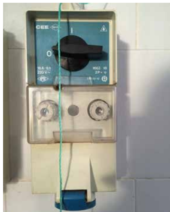
33 e 46. N. 6 interruttori - prese industriali da 220 V (Sala 1 - Edificio A).
