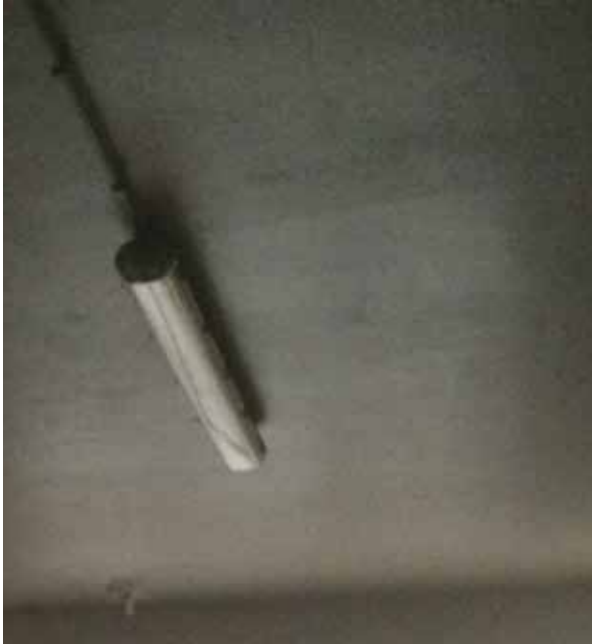
92. N. 4 luci di emergenza ad un neon (Edificio A - 1° Piano)
