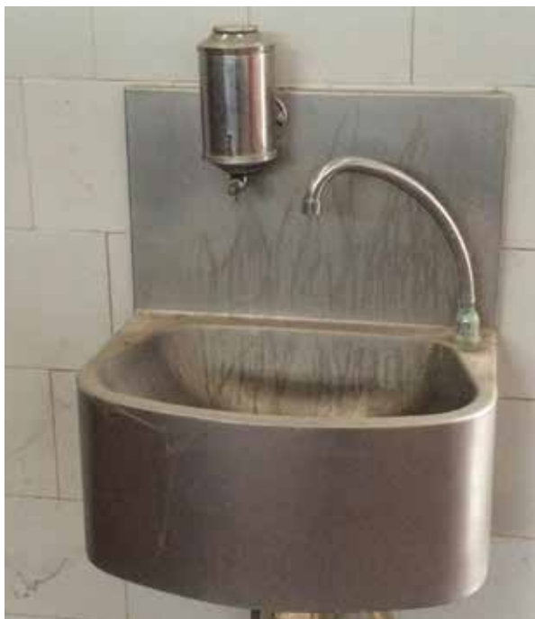
30. N. 2 lavandini in acciaio (Sala 1 - Edificio A).
