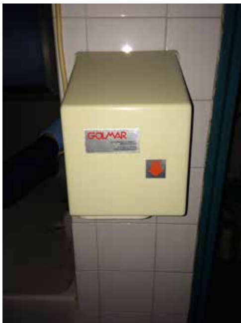
108. N. 2 asciugamani elettrici (Edificio A - 1° Piano)
