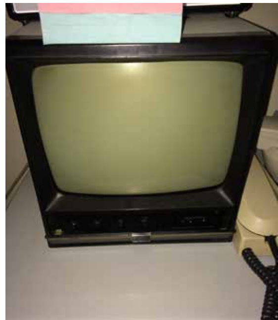
141. Impianto video telefono (Edificio A - 1° Piano zona direzione)
