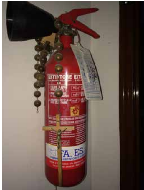
166. Estintore da 2 kg (Edificio A - 1° Piano zona direzione)
