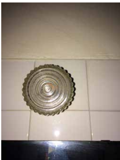
110. N. 2 plafoniere a muro cilindriche in vetro (Edificio A - 1° Piano)
