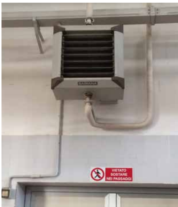
28. N. 6 condizionatori aerotermici per ambienti industriali marca SABIANA (Sala 1 - Edificio A).
