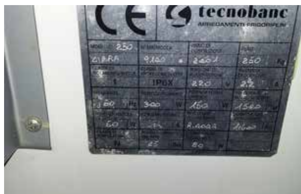
357. Bancone frigo per macelleria mod. Libra anno 2001 matr. 9100 (Edificio C)
