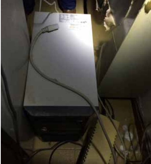
138. Case FUJITSU SIEMENS (Edificio A - 1° Piano zona direzione)
