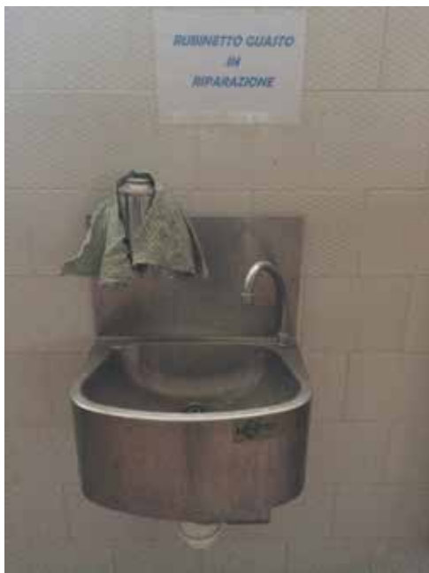
96. Lavandino in acciaio 0,46 m x 0,35 m (Edificio A - 1° Piano)
