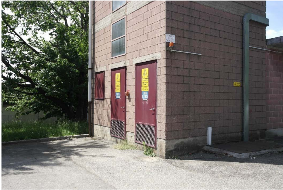
Figura 13: cabina elettrica (Media Tensione)
