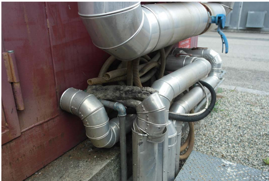
Figura 9: tubazioni combustibile e fluidi refrigeranti
