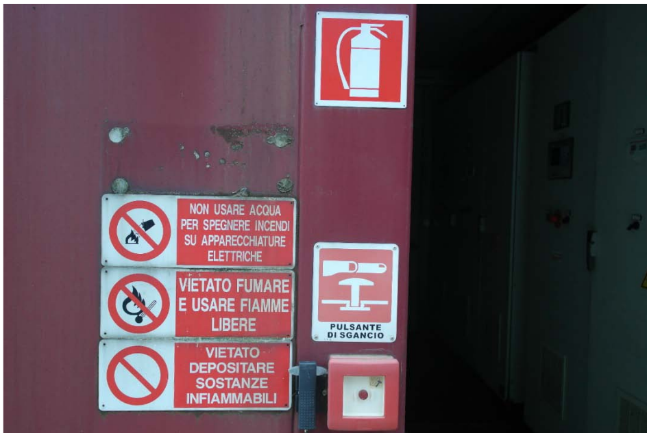
Figura 2: locale tecnico (container) alloggiamento cogeneratori
