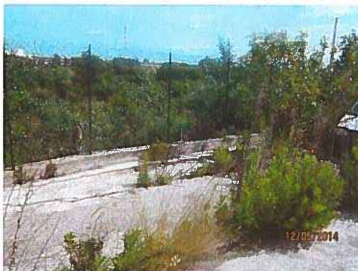
Foto 37: Piazzale esterno cedimento terreno
