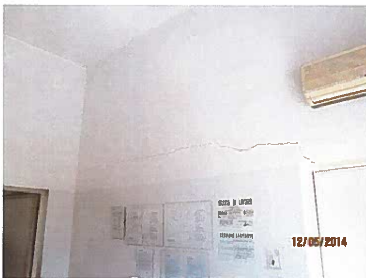
Foto 34: Particolare crepa piano terra
