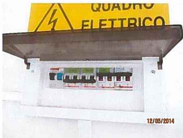
Foto 39: Quadro elettrico piano primo
