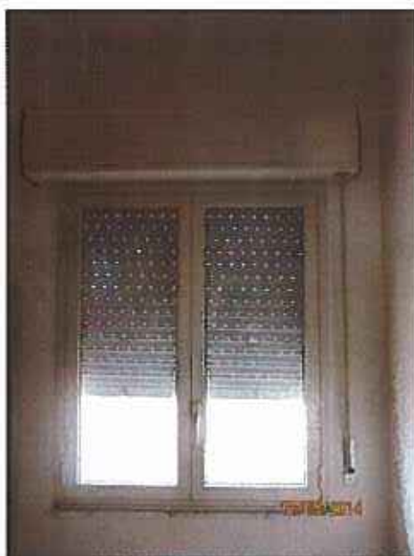
Foto29: Serramenti esterni con avvolgibile e cassonetto
