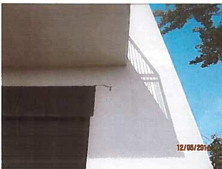
Foto 36: Particolare crepa piano terra
