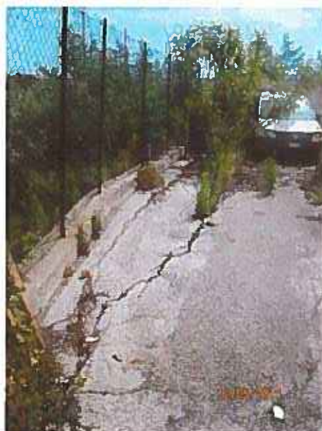
Foto 38: Piazzale esterno cedimento terreno
