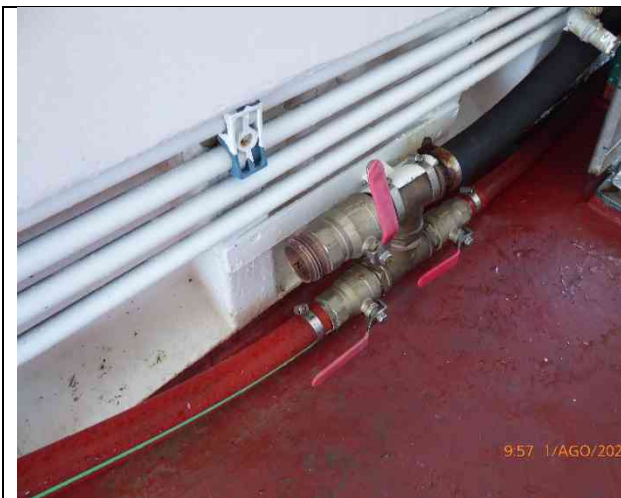
Fotografia 75 – Presa idrica antincendio
