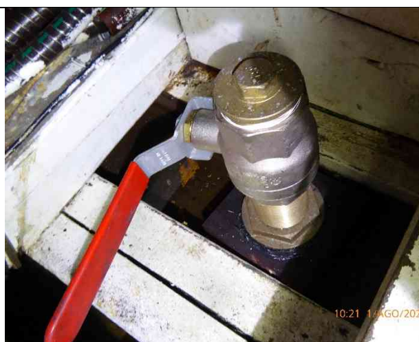
Fotografia 43 – Valvola a scafo cieca
