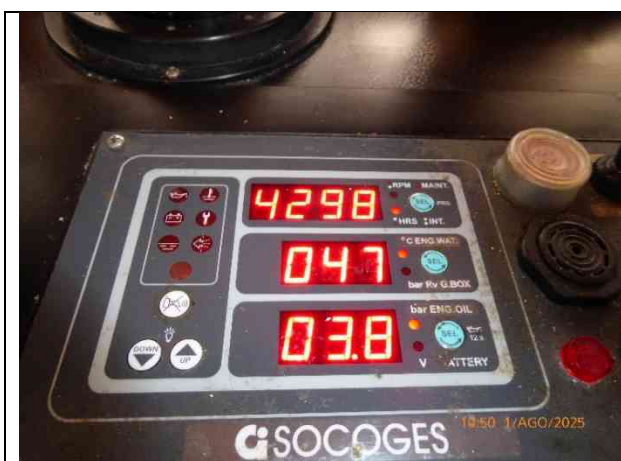
Fotografia 5 – Quadro controllo motore
