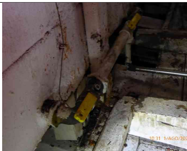
Fotografia 64 – Valvola intercettazione gasolio
