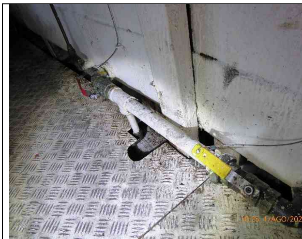
Fotografia 63 – Valvola intercettazione gasolio
