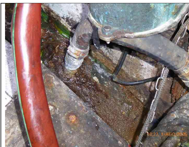
Fotografia 40 – Strutture della macchina del timone
