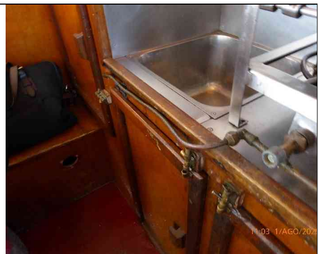
Fotografia 78 – Tubo gas di cucina
