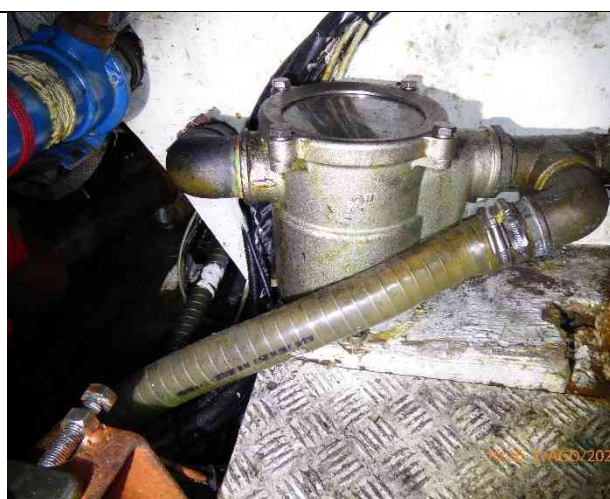
Fotografia 51 – Filtro acqua mare
