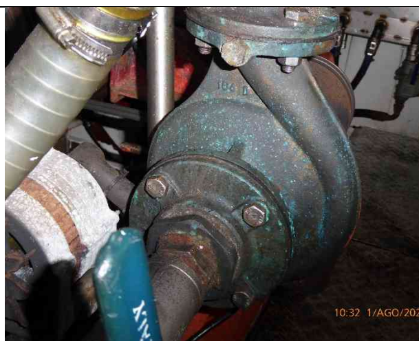
Fotografia 67 – Pompa idrica per lavaggio
