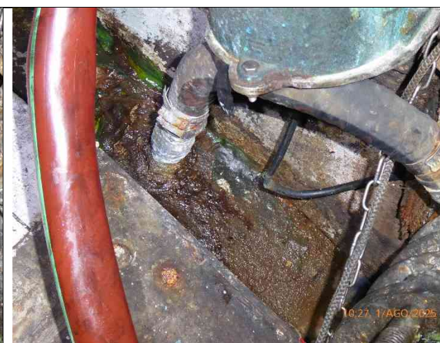
Fotografia 41 – Valvola a scafo raffreddamento astuccio asse porta elica
