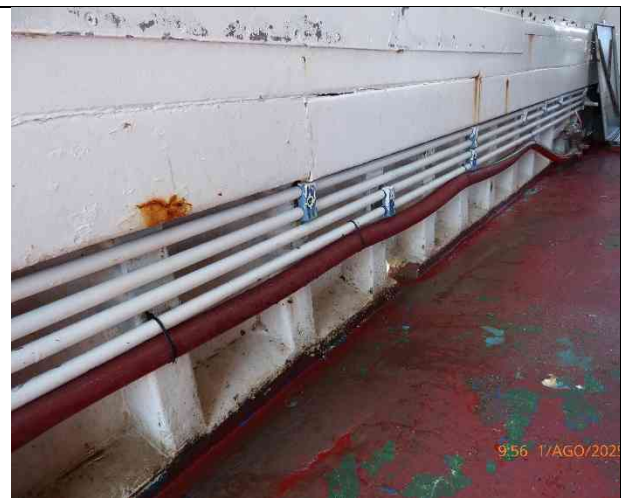
Fotografia 76 – Manichetta antincendio e lavaggio
