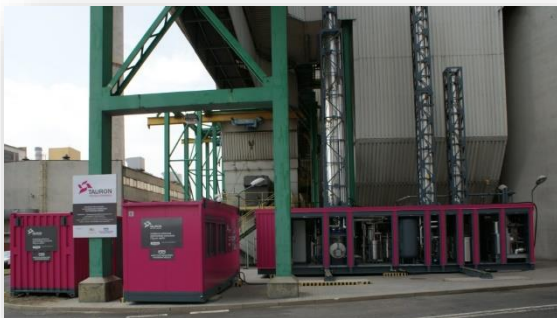
Instalacja pilotowa usuwania CO 2 ze spalin – 200 m 3 /h (2013)
