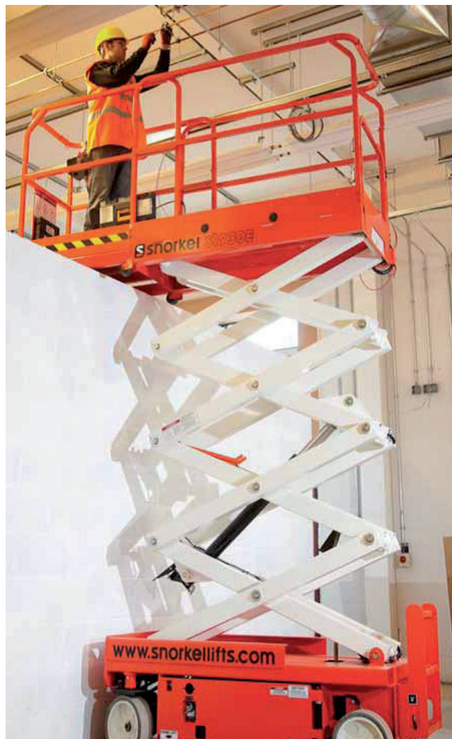
Rys. 5. Prace przy instalacji z wykorzystaniem podnośnika nożycowego – przejezdnego z napędem akumulatorowym (Instant Polska)
