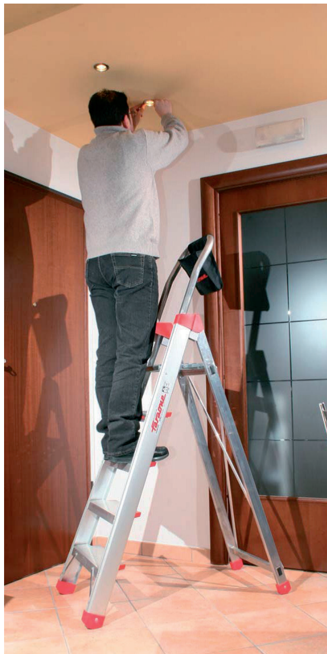
Rys. 1. Praca na drabinie przy konserwacji oświetlenia – widoczny poręczny pojemnik na narzędzia zamocowany przy górnej poręczy (Higher)
