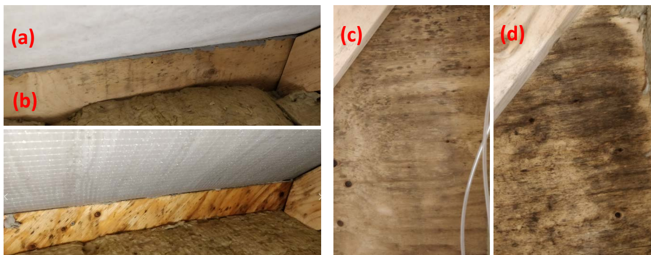
På bundpladen: B5, værste diffusionsåbne rum (a), A9, et af de værste diffusionstætte rum (b). På rumskillende sideplade: B5, værste diffusionsåbne rum (c), A9, et af de værste diffusionstætte rum (d).
