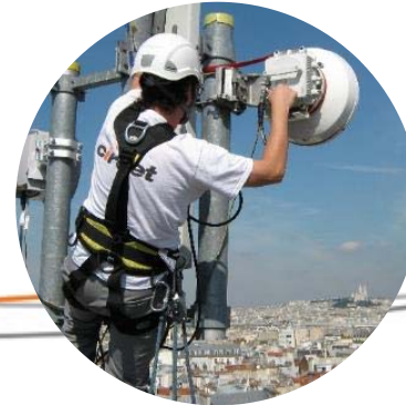
Instalación, swap y recuperación de servicios de equipamientos radios
