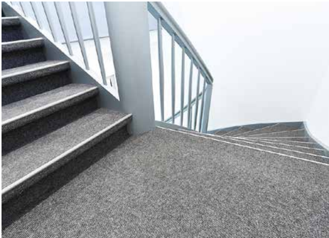
Trappeprofiler laget av aluminium, og kombinert med tretford-tepper, gir vesentlig reduksjon av støtstøy.
