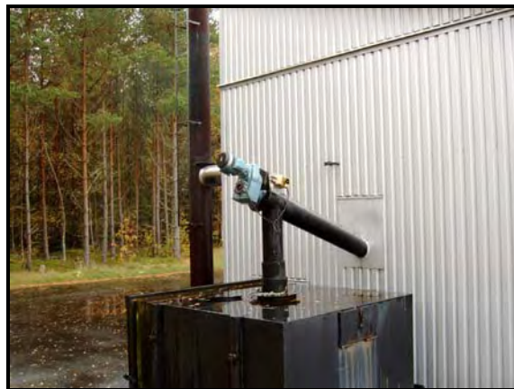
Bild 1 Askcontainer för närvärmeanläggningen på Växjö flygplats. (Foto: T. Andersson)
