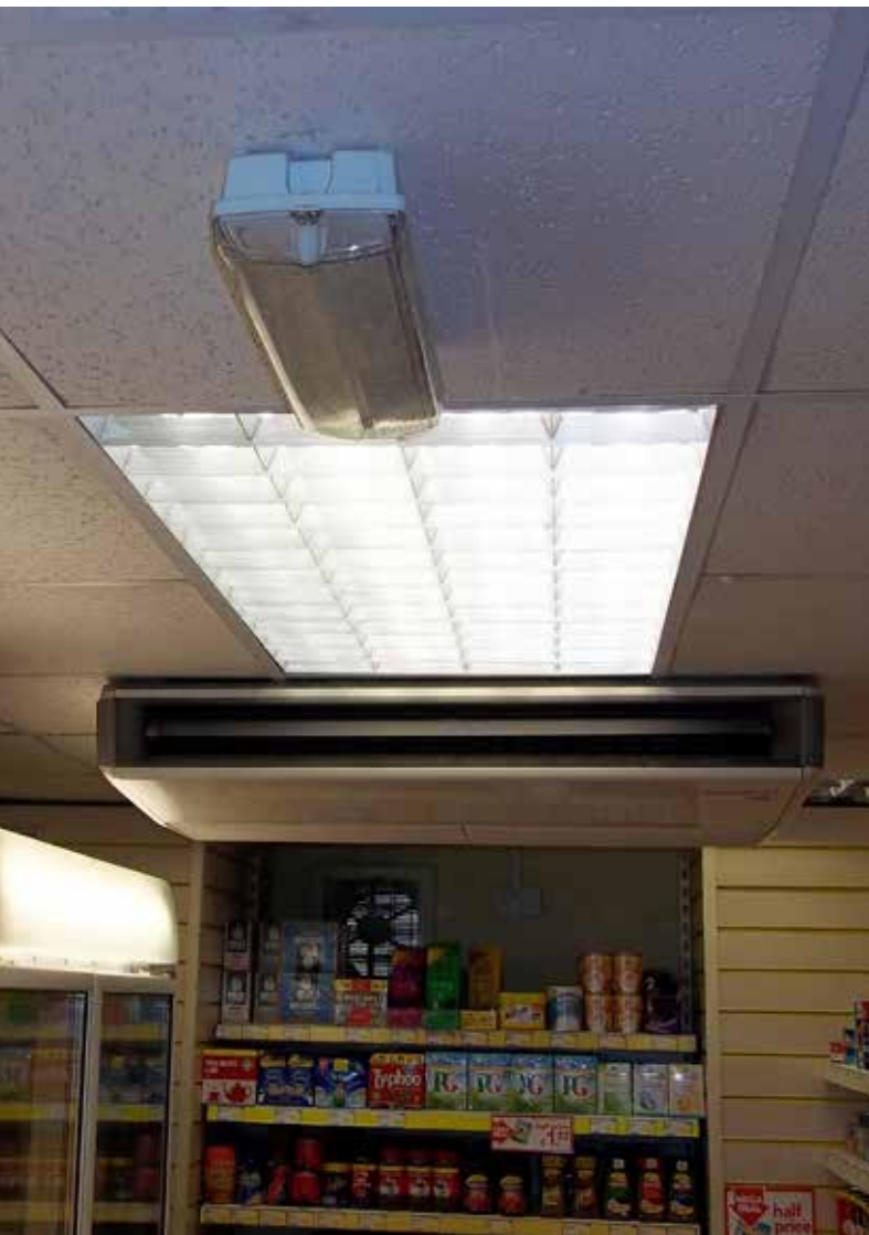
Fig.4: Ursprunglig luftkonditionering och ny frånluftsfläkt i väggen.
