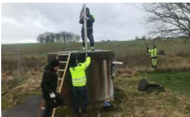
Utloppspumpstationen vid Knislinge reningsverk
