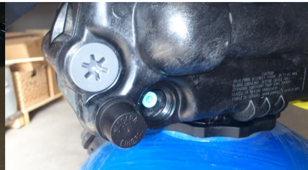
Här sitter injektorn
