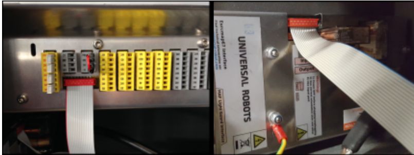
Şekil 19.1: Şerit kablo bağlantısı
