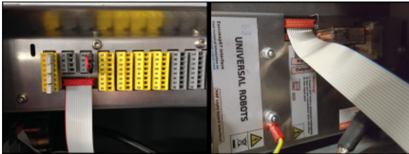
Şekil 19.1: Şerit kablo bağlantısı
