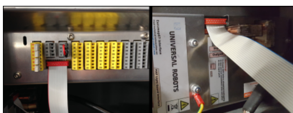
18.1: Połączenie kablem taśmowym
